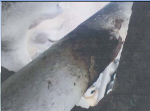
図1-1 破損した配管
