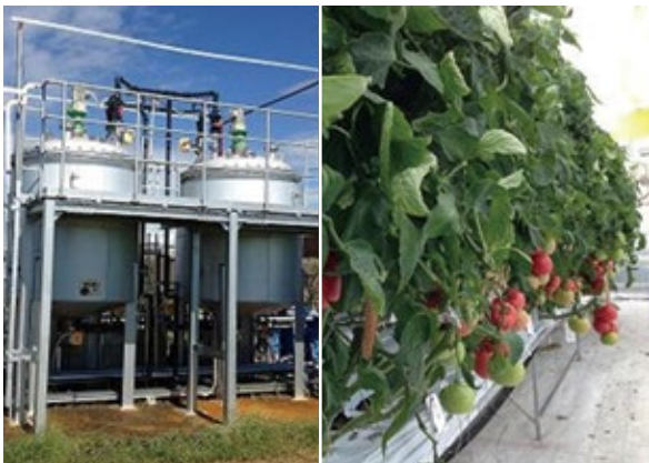
⑤ 下水処理場を核としたバイオマスの利活用の検討 (写真 / 豊橋技術科学大学が中心で行っている豊川バイオマスパーク構想の実証実験 (豊川浄化センター)) (左 / メタン発酵施設 右 / バイオガスを活用したトマト栽培)
