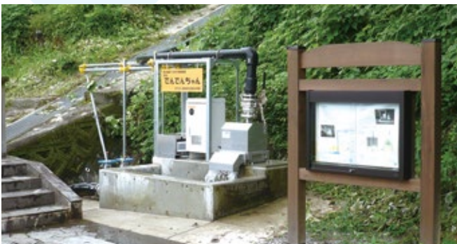
農業用水を利用した小水力発電施設(新城市四谷地区)
