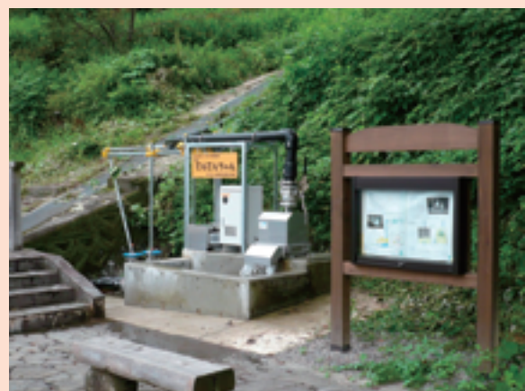
農業用水を利用した小水力発電施設（新城市四谷）
