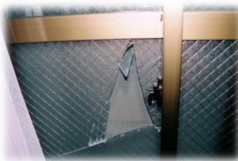
窓のガラス割
