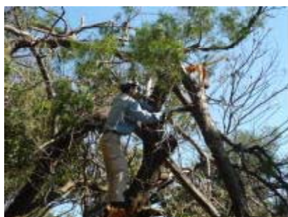
台風18号被害木処理
