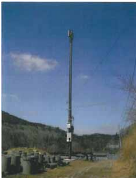
新設された携帯電話基地局（設楽町田峯地区）
