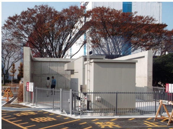
平成 25 年度に 72 時間化を実施した 県西庁舎の非常用発電機
