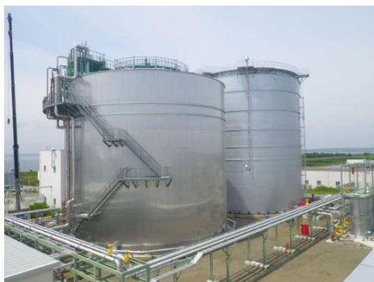
下水汚泥メタン発酵施設
