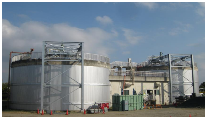
下水汚泥メタン発酵施設
