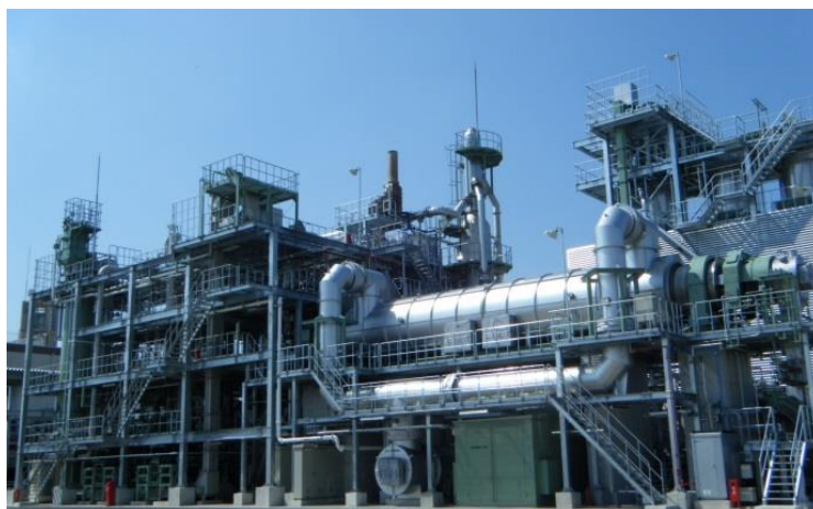
下水汚泥燃料化施設
