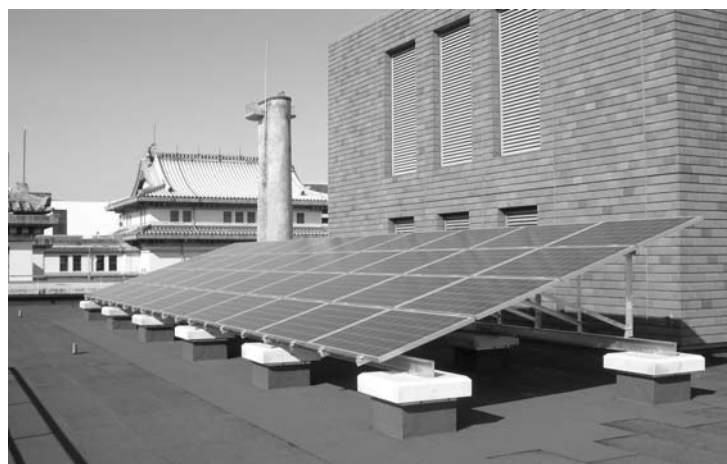
太陽光発電設備（愛知県議会議事堂）
