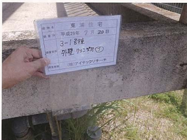
3-1号棟 外壁 リシン吹付③
