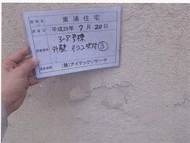
3-8号棟 外壁 リシン吹付③
