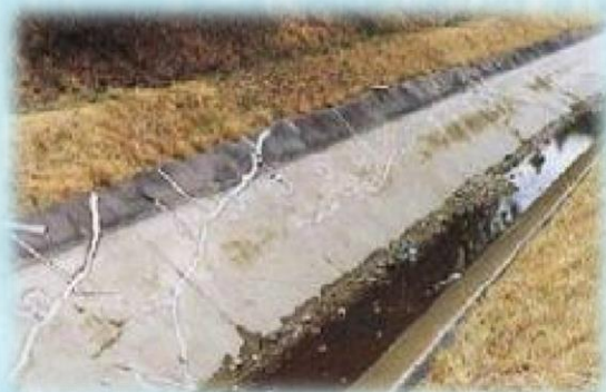
幹線水路のひび割れ
