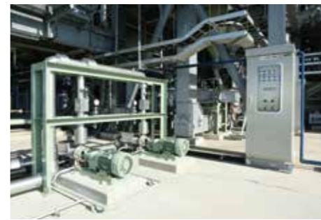
⑤ スクラバ排水供給ポンプ 焼却設備排煙処理塔(スクラバ)から得られた排熱を有効利用することで消化槽の加温に必要な熱量(重油274kL/年相当分)を補助的に供給します。
