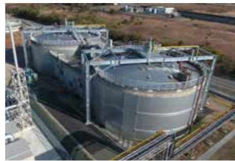
② 消化槽 高温・高濃度消化方式を採用することで、消化槽を増設することなく既存のRC躯体消化槽を利活用しました。また、消化槽攪拌機は超低速型パドル式により、電力の大幅な低減を図ると共に、完全攪拌により汚泥の減容化と消化ガス発生量の最大化に寄与します。
