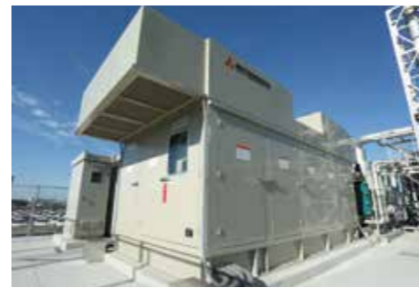
④ ガスエンジン発電機 嫌気性消化によって得られた消化ガスをガス貯留タンクに一旦貯留し、発生ガス量に適應した発電出力制御運転を行います。また、発電で得られる排熱を温水に変換することで、消化槽を間接的に加温します。
