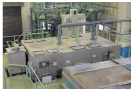
① ベルト濃縮機 重力濃縮→機械濃縮へ2段濃縮することで、高濃度汚泥を後段の消化槽へ供給します。2段濃縮時の濃度変動にも適応可能なベルト式の採用により、安定した汚泥濃度が供給できます。
