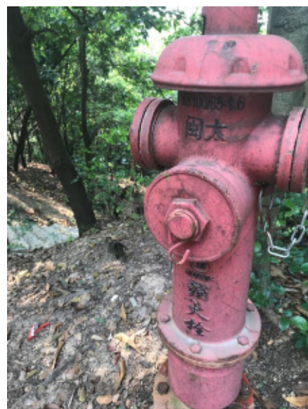
紫雲閣 消火栓
