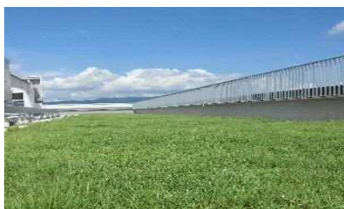
公共施設の屋上緑化(愛西市)
