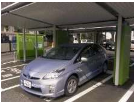
EV・PHV 充電施設（豊田市）
