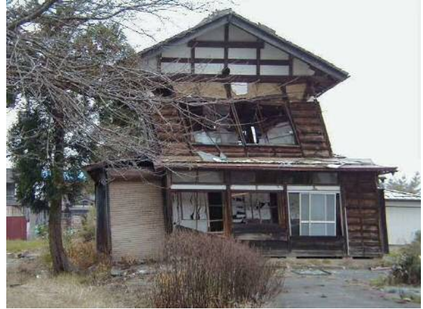
一見して住家の一部の階が全部倒壊
