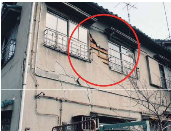
塗り壁では仕上の大半が剥離・脱落
