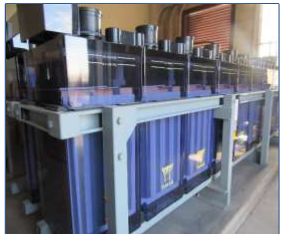
【老朽化した電話交換機用蓄電池】
