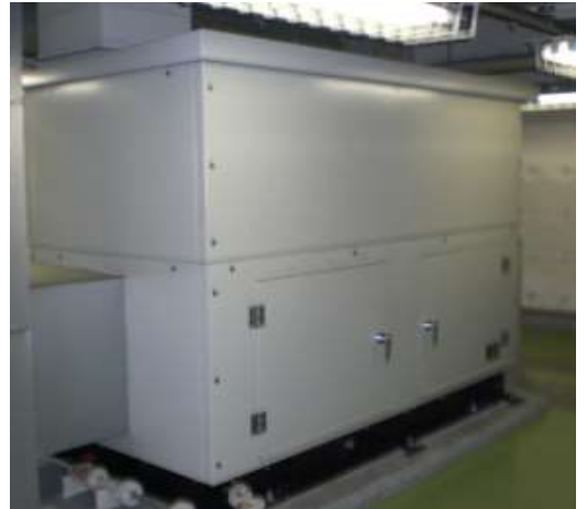
【非常用発電機の72時間化】
