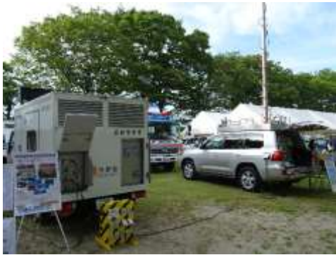
【写真1 電源車から送信車輛への給電】
