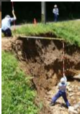
【被災状況調査】 (岐阜県関市)
