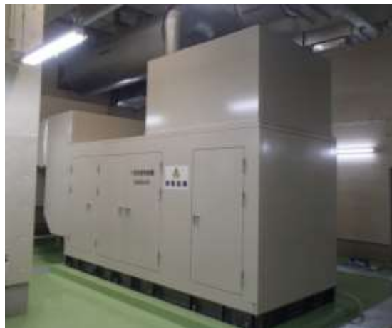
【非常用自家発電設備の整備】
