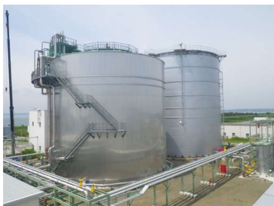
下水汚泥メタン発酵施設
