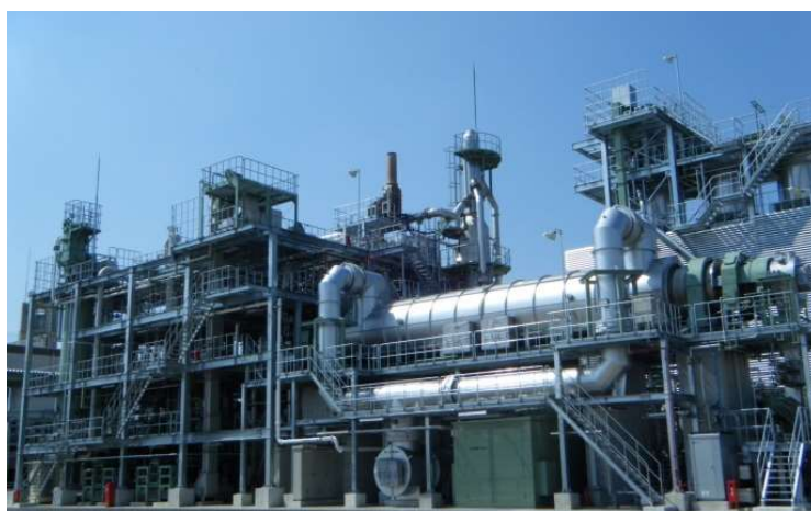
下水汚泥燃料化施設
