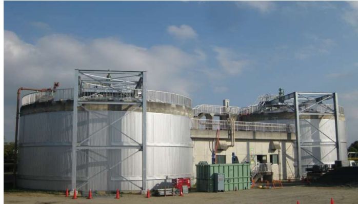
下水汚泥メタン発酵施設
