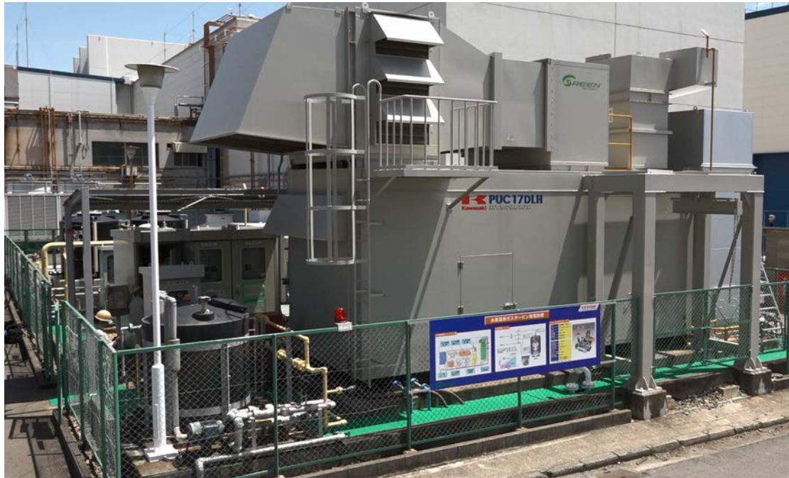
川崎重工 明石工場 自家発電設備
