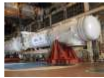
石炭ガス化複合発電 ガス化炉
