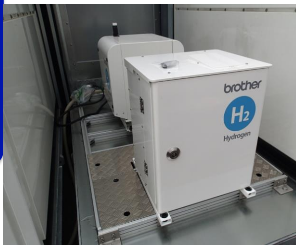
コンテナ型データセンター バックアップ実証
