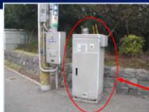
エンジン発電機
