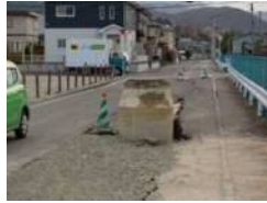
マンホールや上下水道管等が浮き上がったりします。
