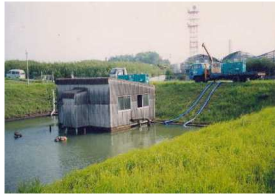
上野浄水場スラジピット排水状況(9/13)
