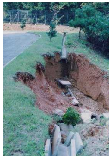
阿久比広域調整池法面崩壊状況(9/12)
