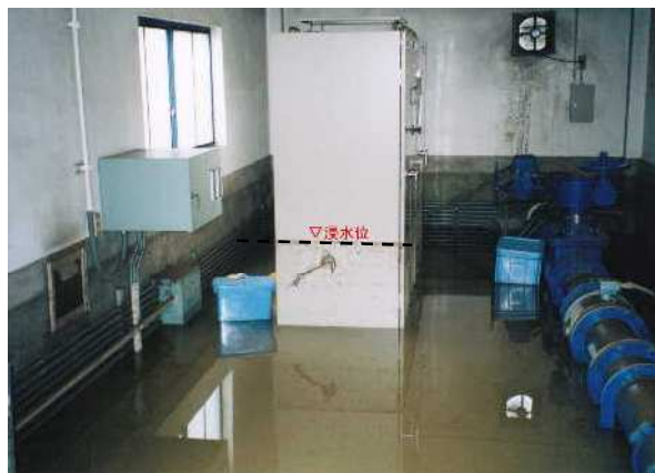
豊明第1供給点浸水状況(9/12)
