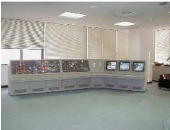
尾張東部浄水場 管理室
