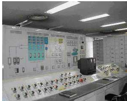
東郷浄水場 管理室
