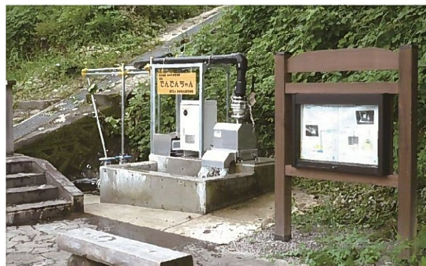
農業用水を利用した小水力発電施設(新城市)
