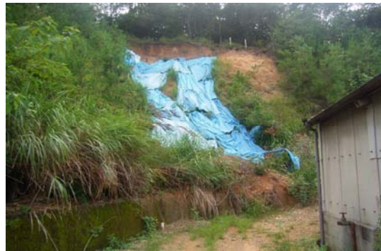
崩壊した山腹
