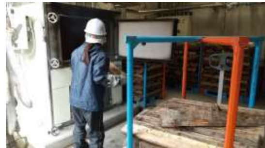
木質バイオマスボイラーへの薪投入
