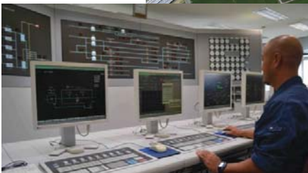
取水量を変更している作業状況
