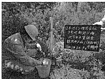
日本ガイシ 知多事業所 9号地産業廃棄物処分場新設 工事における地下水水質調査 〈写真説明〉 観測井No.1(北西側) 【干潮時】 採水採取状況 調査日：令和3年6月9日
