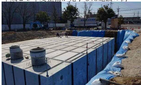
平成29年度整備が完了した施設の例
