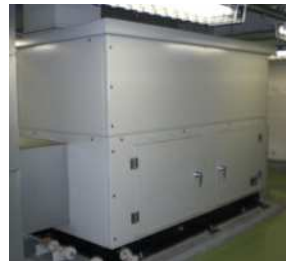
非常用発電機
