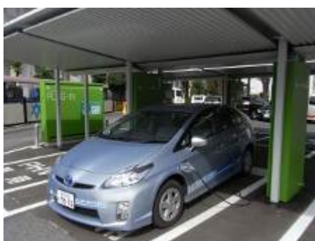
EV・PHV 充電施設（豊田市）
