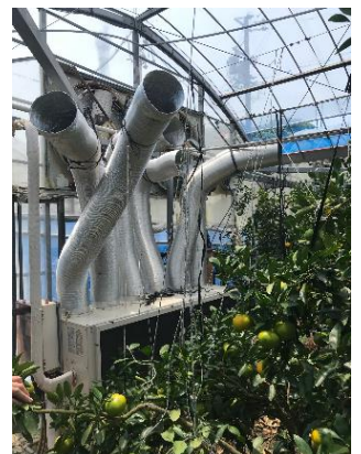
夜間冷房に使用する ヒートポンプ
