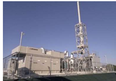
▲バイオガス発電機
