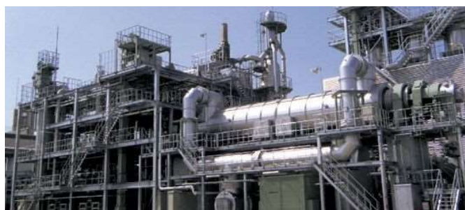
▲汚泥燃料化施設
