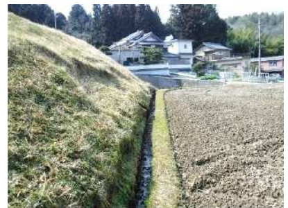
はらみだし及び陥没
