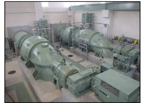
北浜川排水機場 ポンプ設備（西尾市）
