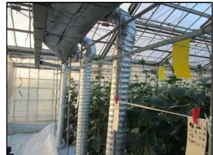
きゅうりの炭酸ガス局所施用(ダクト)
