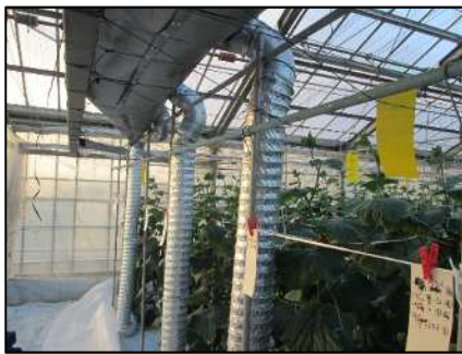
きゅうりの炭酸ガス局所施用(ダクト)
