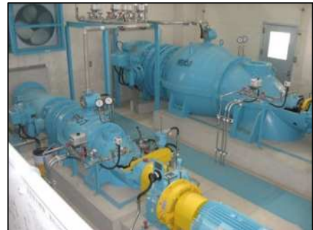
荻原排水機場 機械類工（西尾市）
