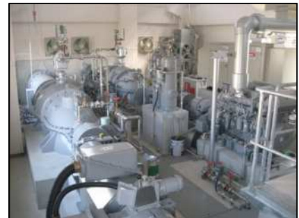
藤江排水機場（西尾市）
