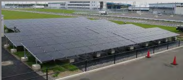
太陽光パネル
