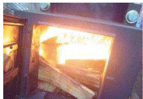
薪ストーブの燃焼状況 (H25 新城市)
