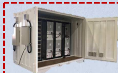
燃料電池システム
