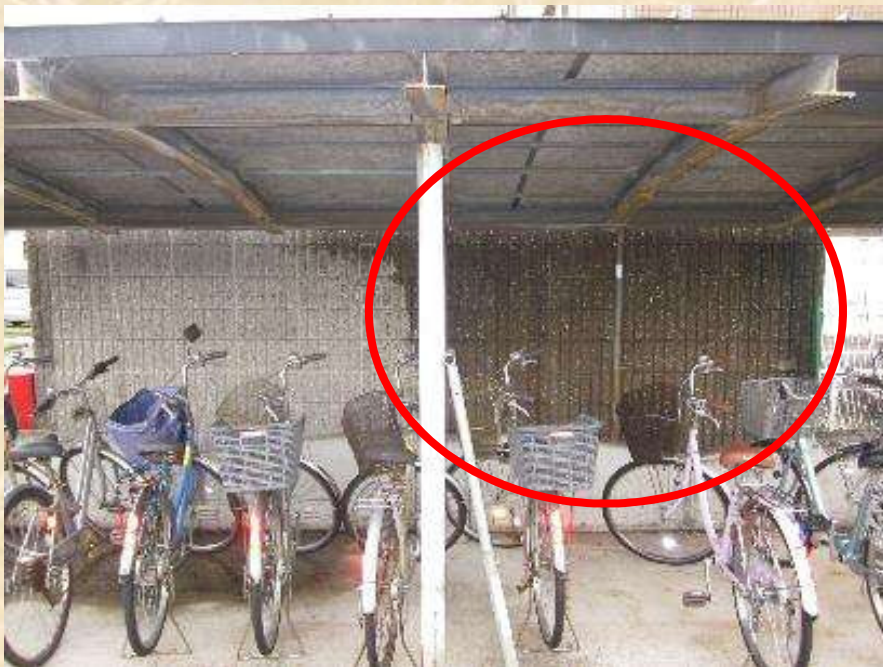
壁面への重油の漏えい状況 (○部分に重油が付着している。)
