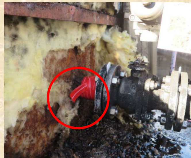
配管の漏えい箇所 (○部分が漏えい箇所。漏水防止テープにて応急措置を実施)
