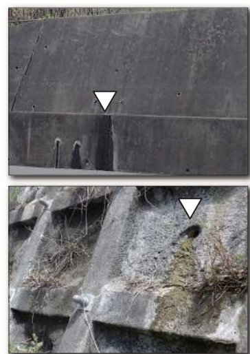
地下水の流出
