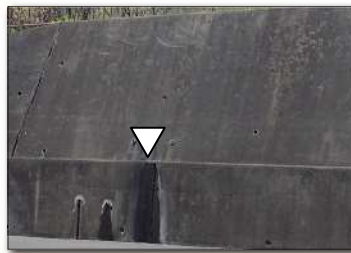
地下水の流出
