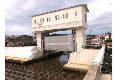
水門の改築（耐震化、自動閉鎖化） （美浜海岸布土川樋門（美浜町））
