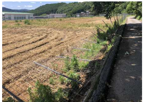
増水により倒壊した侵入防止柵（岡崎市）
