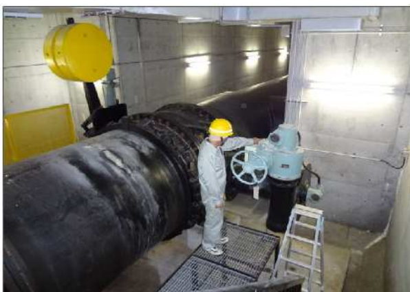
【現場訓練の状況（緊急遮断弁設定確認）】
