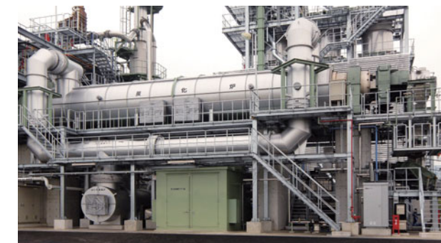
④炭化炉(熱風式外熱キルン) 造粒された乾燥污泥を、熱風により間接加熱にて炭化温度500~600℃滞留時間1時間で炭化処理を行います。
