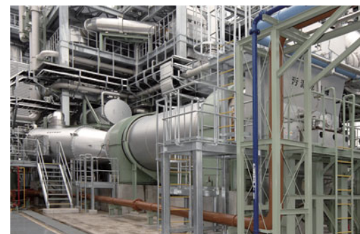
②污泥乾燥機(攪拌機付き回転キルン) 熱風温度を約600℃に調整しながら下水污泥を水分20~30%となるまで1時間程度乾燥させます。
