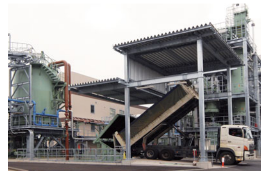
①ケーキ貯留ホッパ(115m 3 )・ ケーキ受入ホッパ(30m 3 ) 搬入された脱水污泥を一時貯留します。
