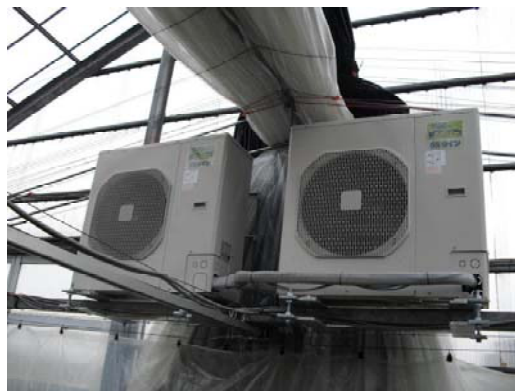
写真1 ヒートポンプ室内機の設置状況
