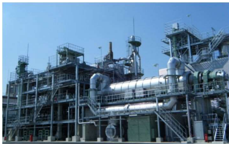
污泥燃料化施設全景
